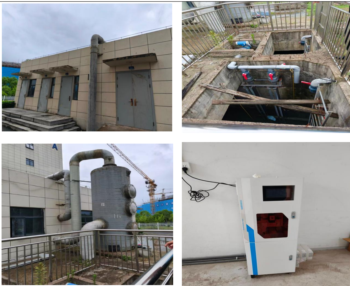
图 3-2 企业自建污水站实拍图
