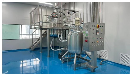
综合车间 2F：配料罐
