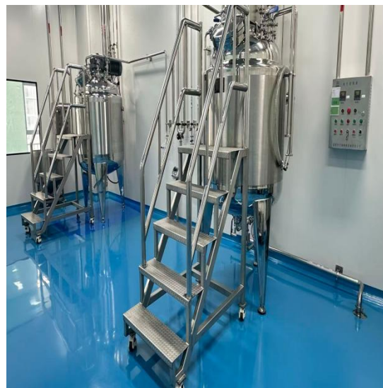
综合车间 2F：化胶罐
