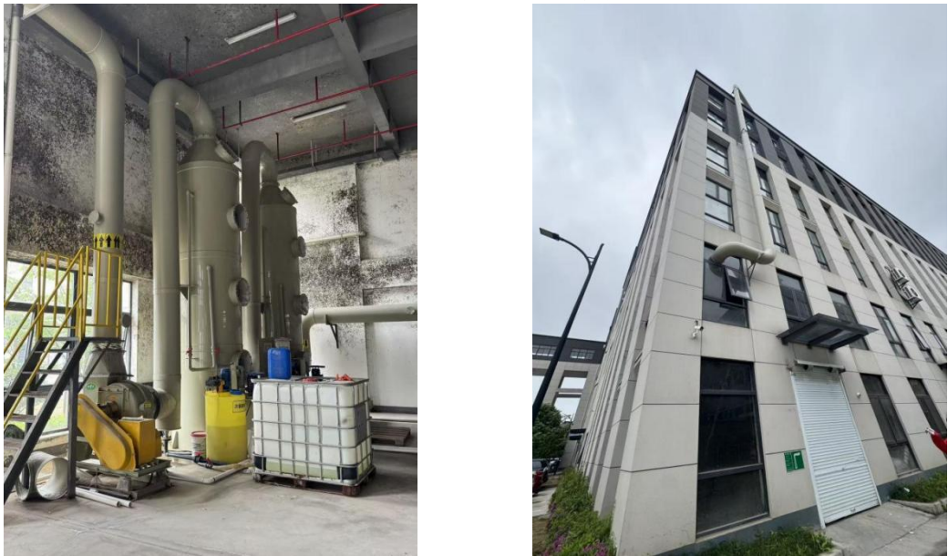
污水站臭气处理装置
