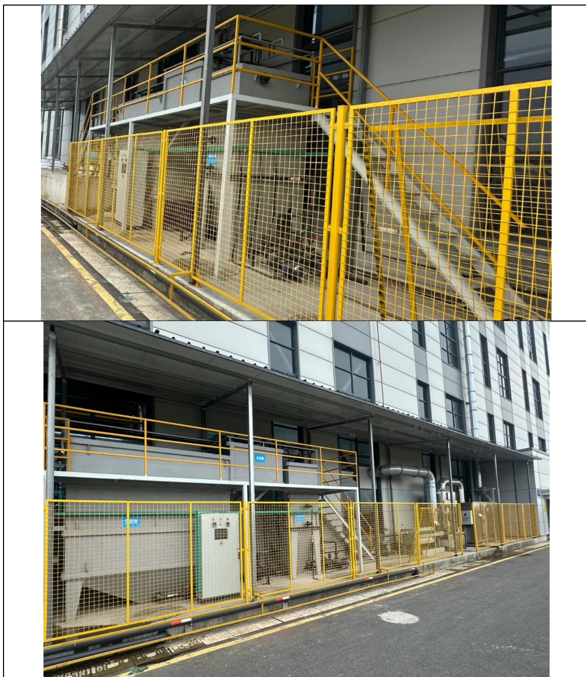
废水处理设施
