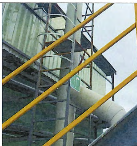
污水站生化段
