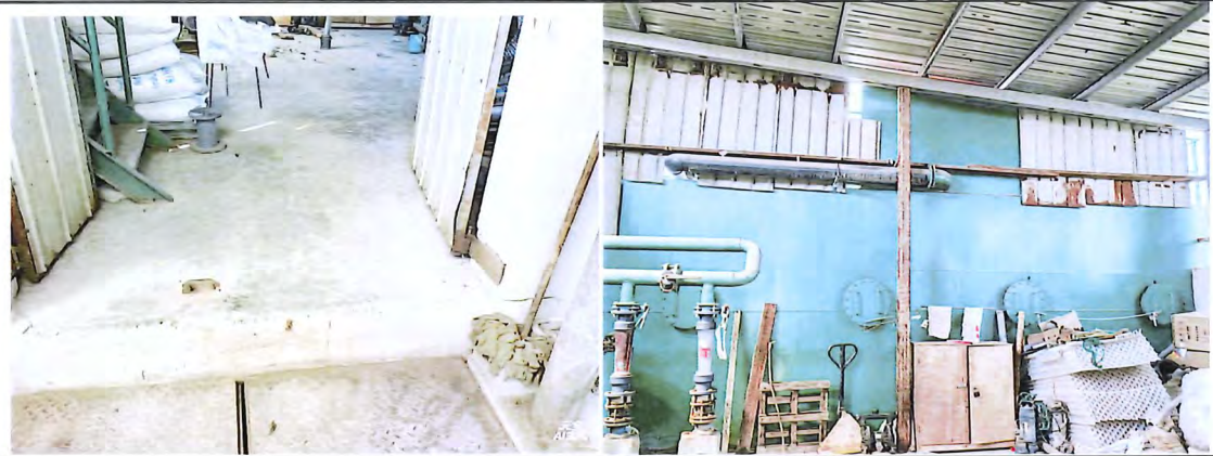
调节池及过滤器（作为应急池使用）
