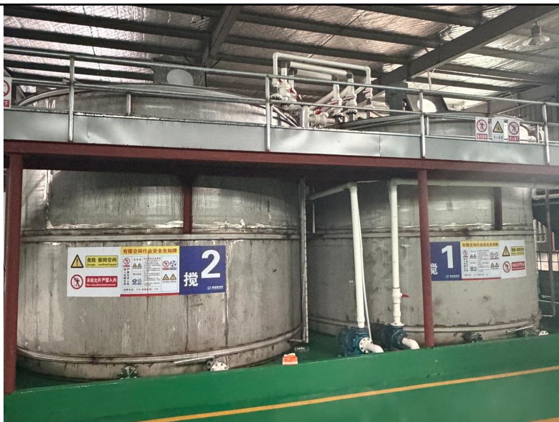
搅拌罐及配套混合搅拌机、变频减速机
