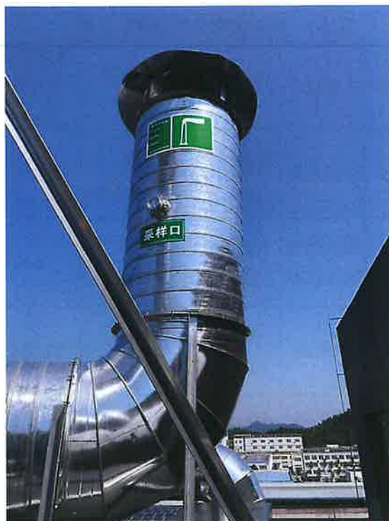
图 4-1 吹膜、印刷废气处理设施现场图
