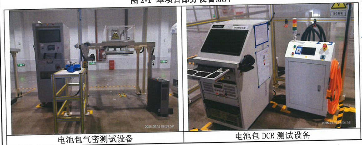
图 2-1 本项目部分设备照片
