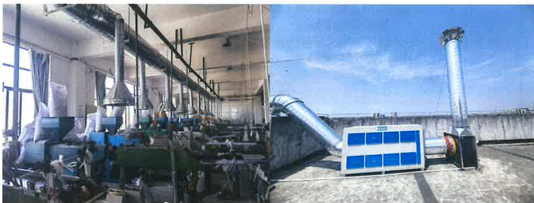
图 3-1 挤出废气废气收集处理设施
