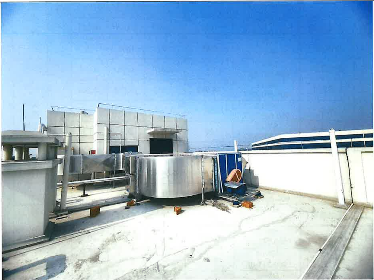
图 3.1.2-1 食堂油烟废气收集处理设施
