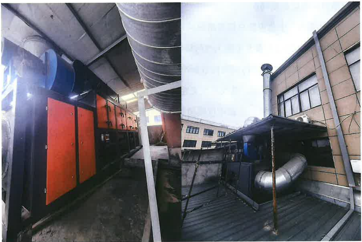
图 3-2 印刷废气、吹膜废气废气收集处理设施
