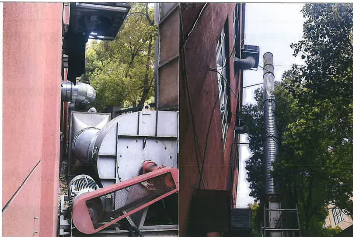
图 3.1.2-1 注塑废气收集处理设施
