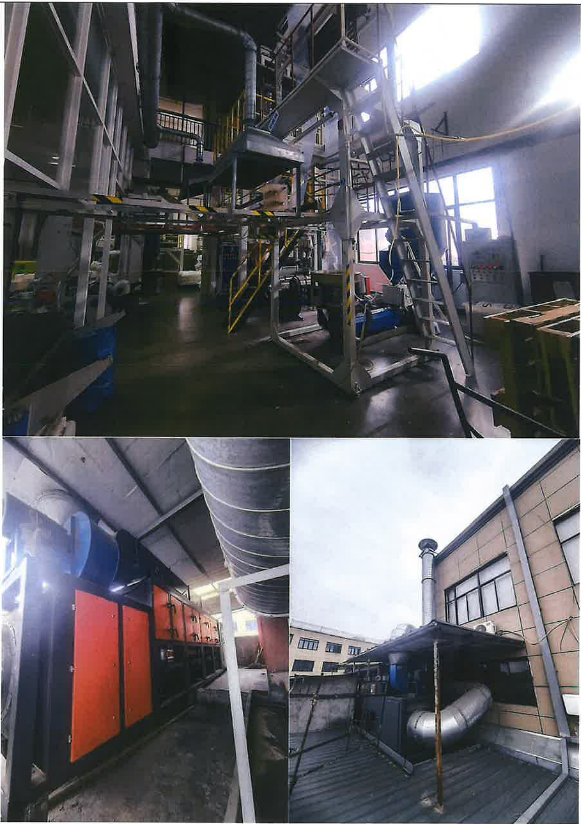
图 3.1.2-2 印刷废气、吹膜废气收集处理设施
