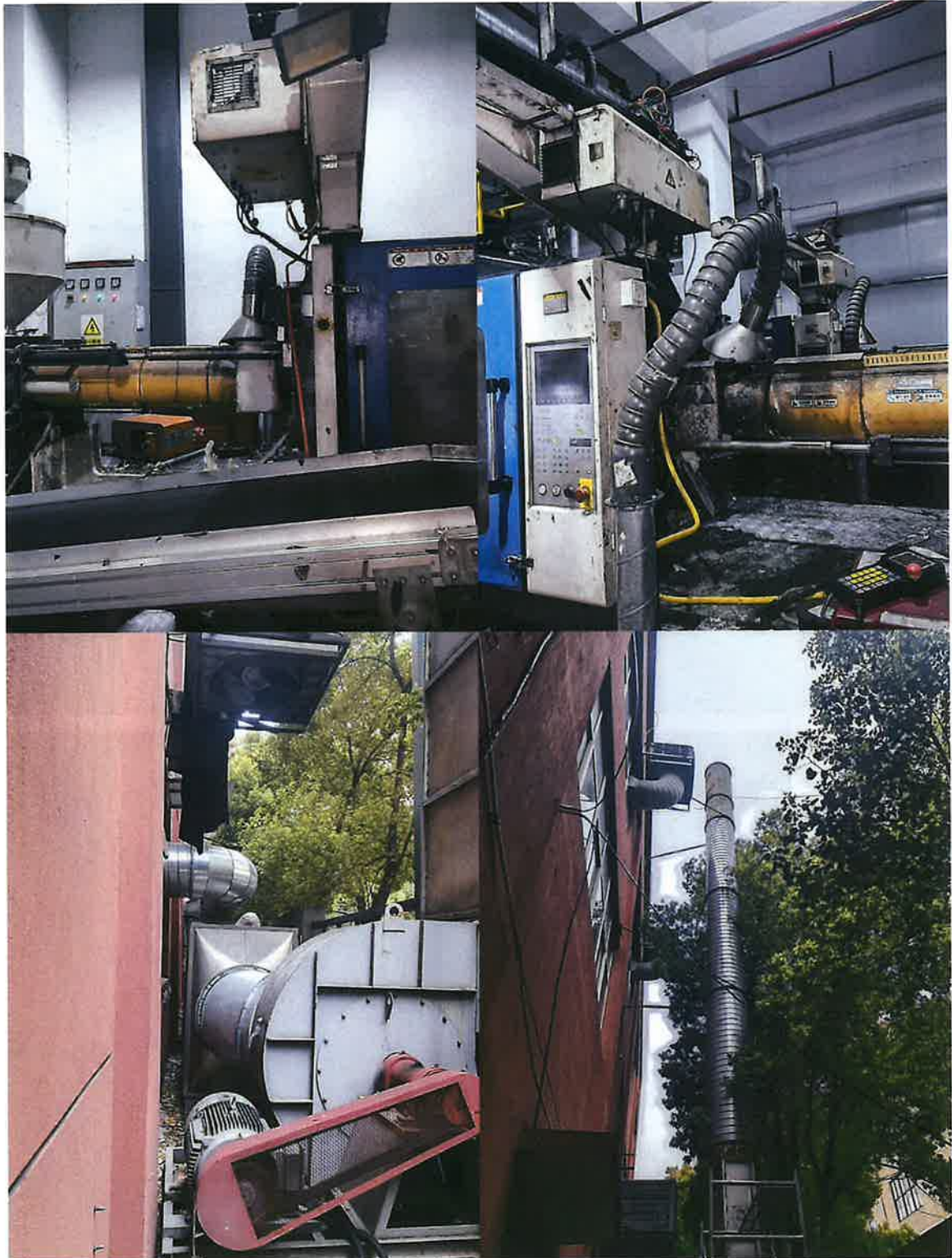
图 3-1 注塑废气收集处理设施
