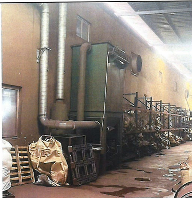
布袋除尘装置-粉尘废气
