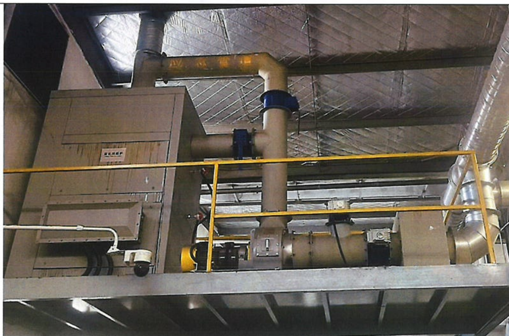
风冷+金属丝网过滤+CO 催化燃烧装置-烧结废气
