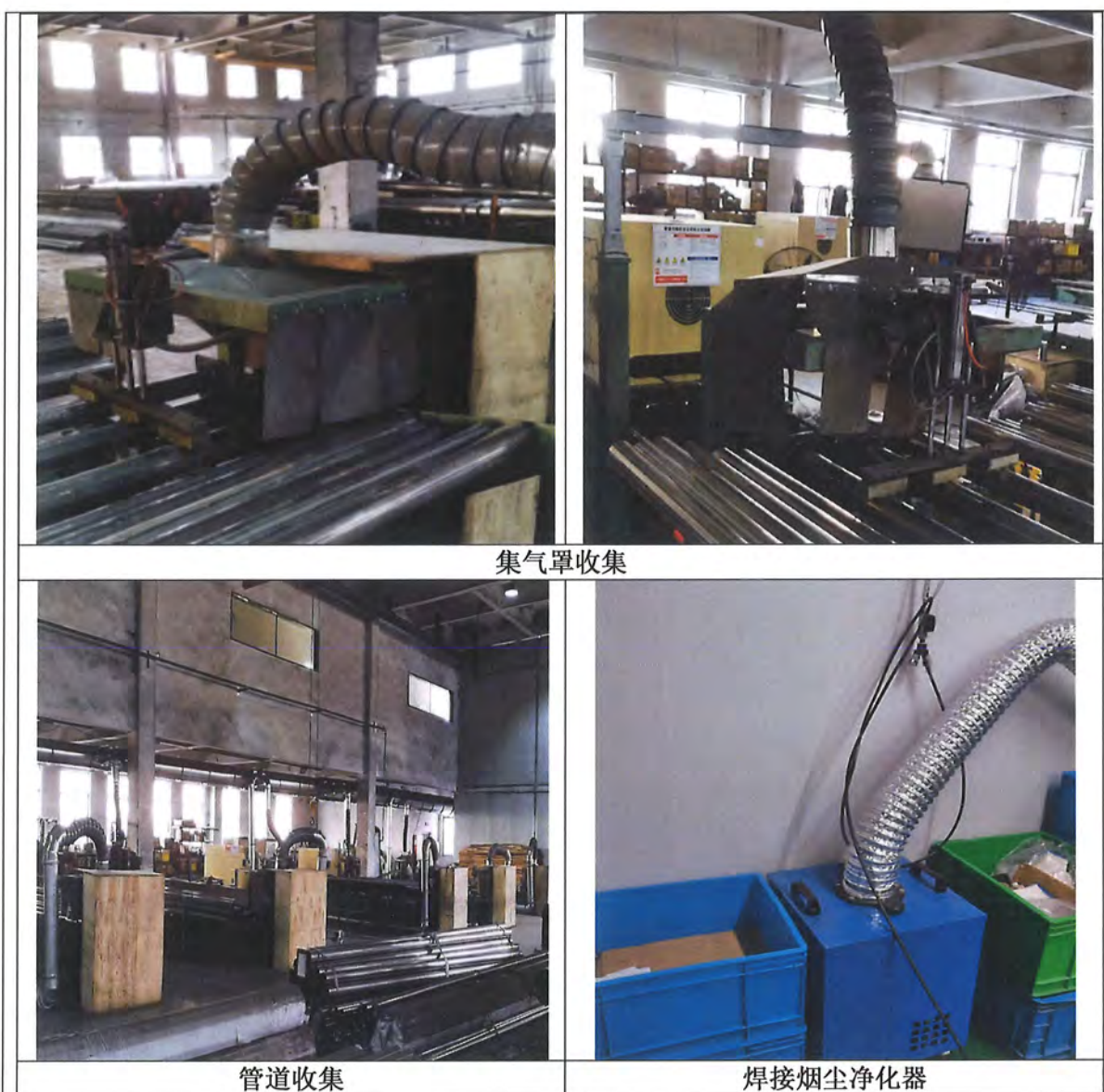
图 3.1-4 废气处理装置照片
