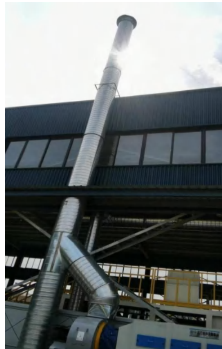
图 4-5 有机废气处理装置
