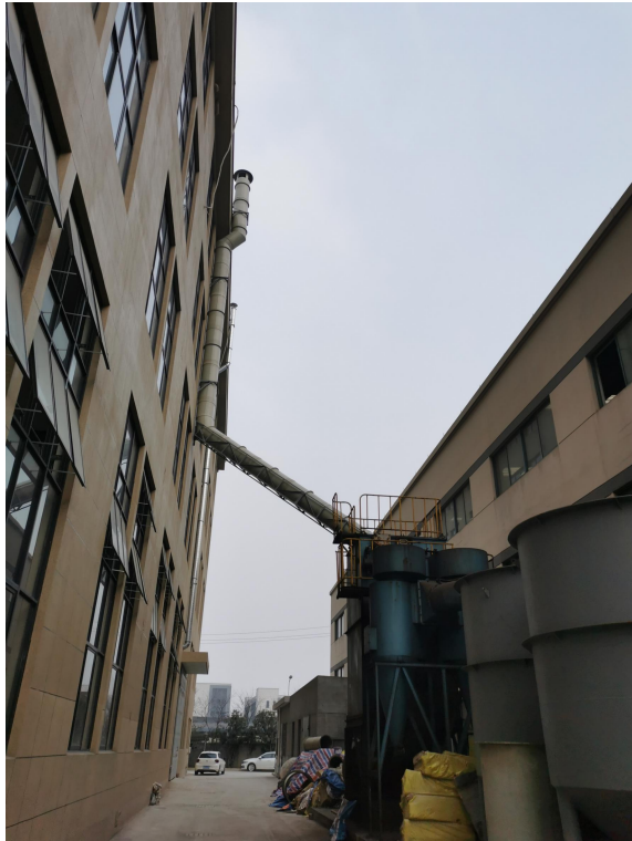
图 4-1 喷砂粉尘处理装置
