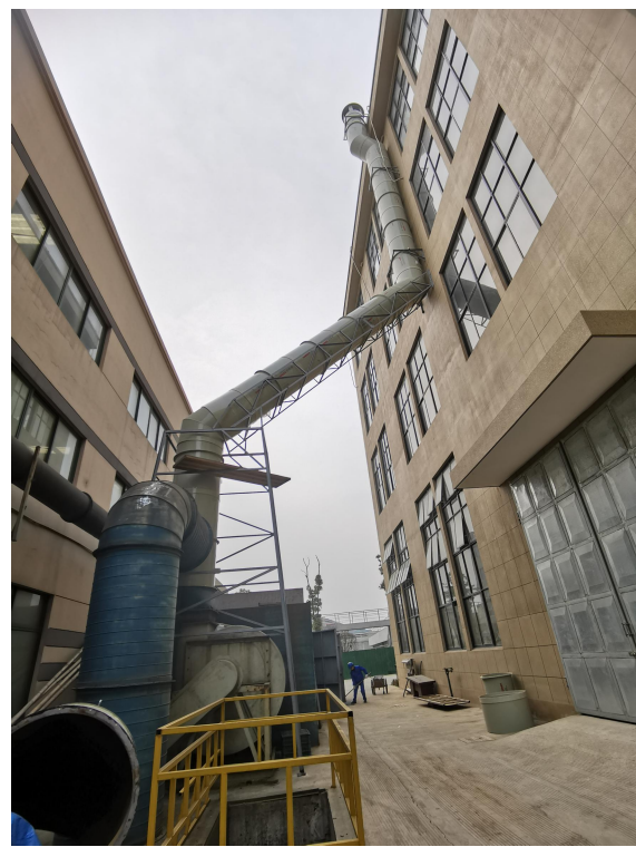
图 4-2 油漆废气处理装置
