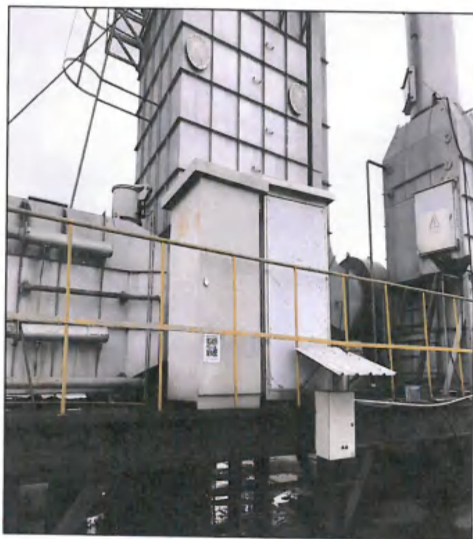
图 4-1 定型废气处理设施
