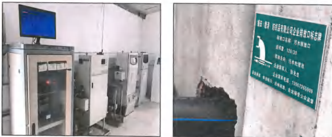
图 4-5 污水站出口监控设备及排放口标识
