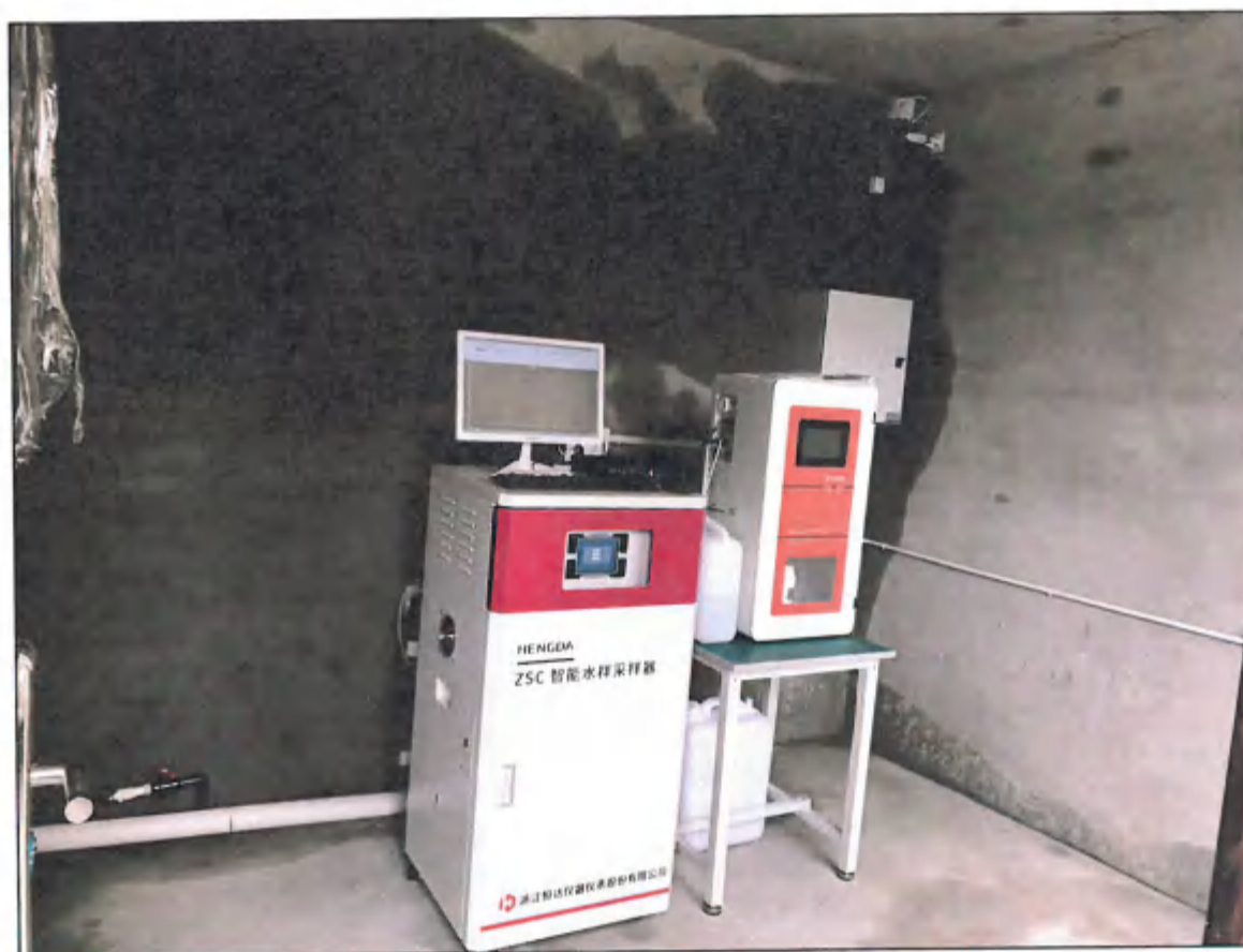
图 4-4 车间出水监控设备
